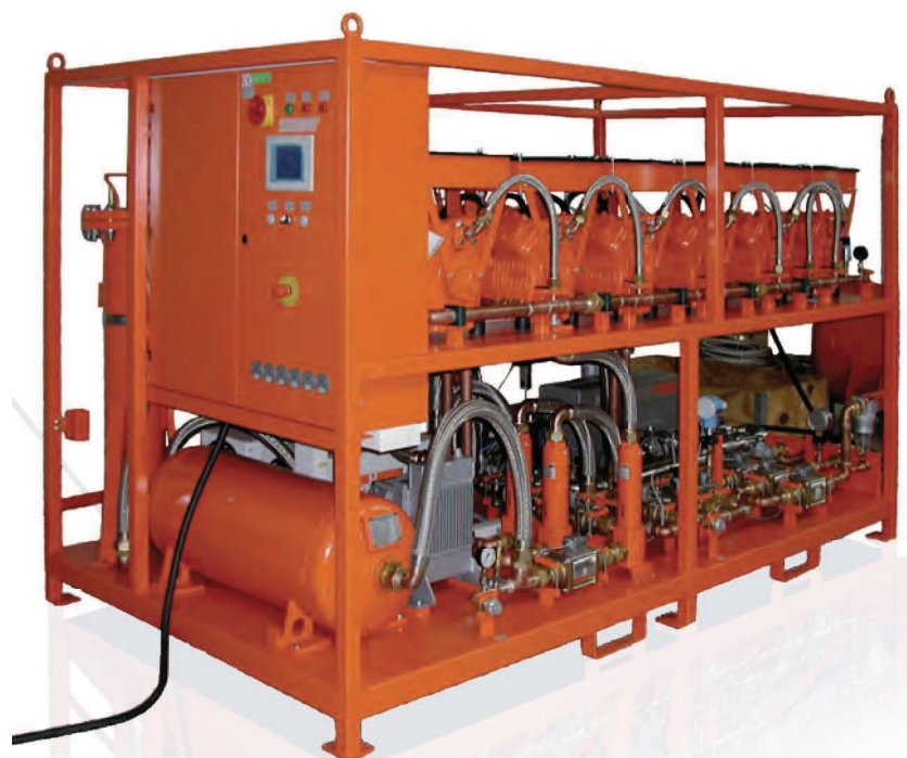
Planta de manuseio de gás SF 6 para um acelerador de elétrons
